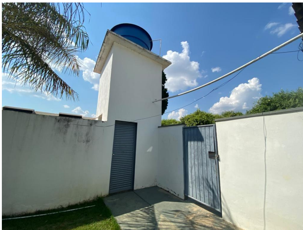
Foto 44 – 5.10. Depósito / Caixa de Água
