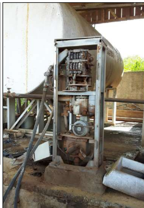
Foto 18 – Bomba de combustível danificada e apresentou imprecisão no abastecimento - está em desuso a mais de 5 anos.
