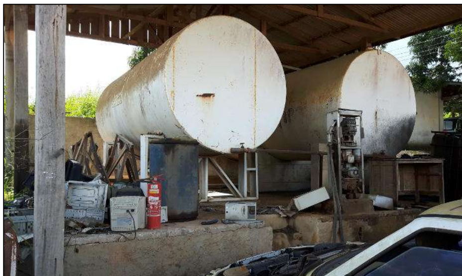
Foto 17 – Dois tanques de combustíveis de 10 mil litros cada em desuso a mais de 5 anos.
