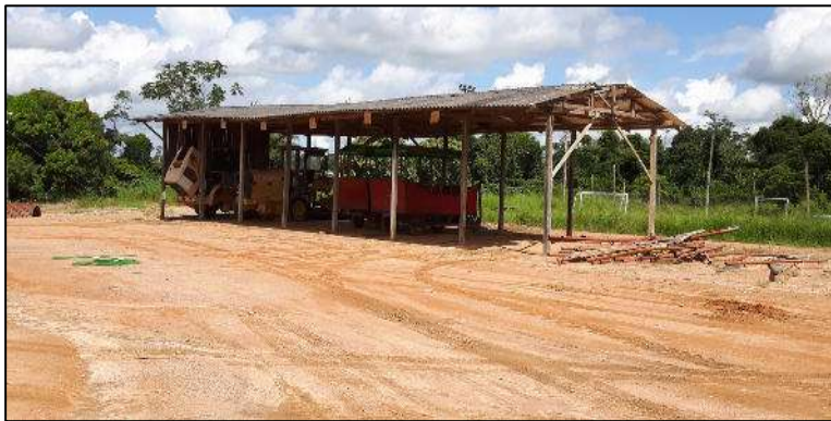
Foto 21 – Pátio da Secretaria de obras – Construção antiga com estrutura danificada em madeira com risco de desabar.
