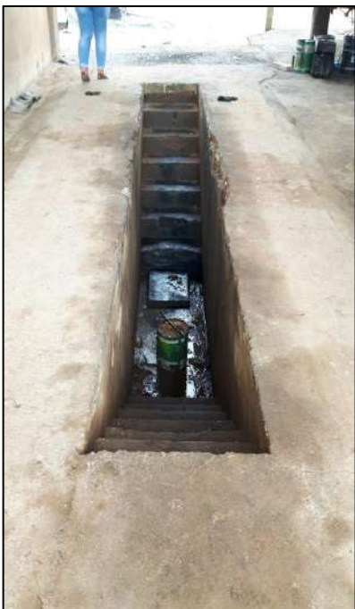
Foto 42 – Rampa da oficina pequena e sem ralo para escoamento/vazão de água.
