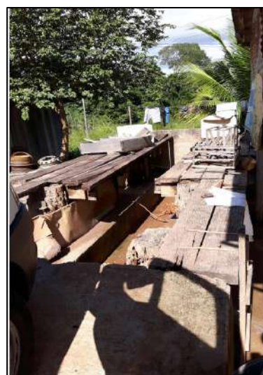
Foto 64 - Lavador - Rampa em madeira e danificada.
