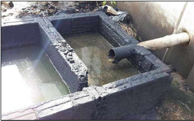
Foto 40 – Sistema de descarte de resíduos de óleo – danificado não funciona.
